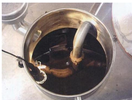
Figura 6.7. Parte superior de un depósito autovaciante.
