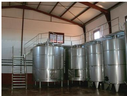
Figura 6.32. Vistas de la parte superior de los depósitos de encubado.
