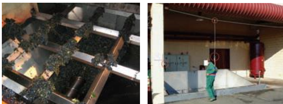
Figura 6.30. Rejilla de la tolva de recepción (izda.) y sistema arnés anti caída (drcha.).
