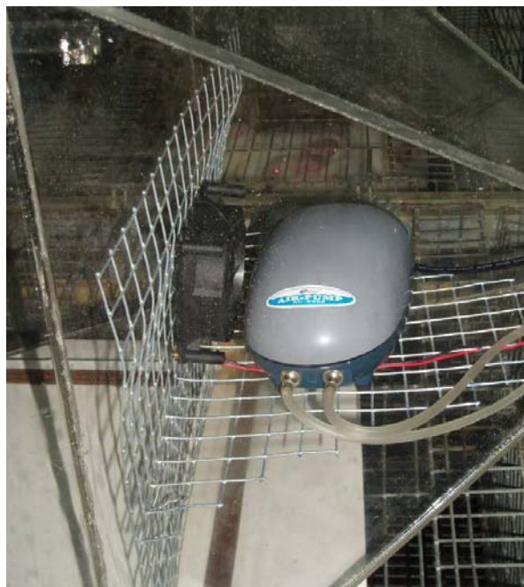
Figura 37. Bomba y ventilador instalados en la cámara
