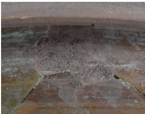
Fig. 79: detalle de la suciedad superficial
