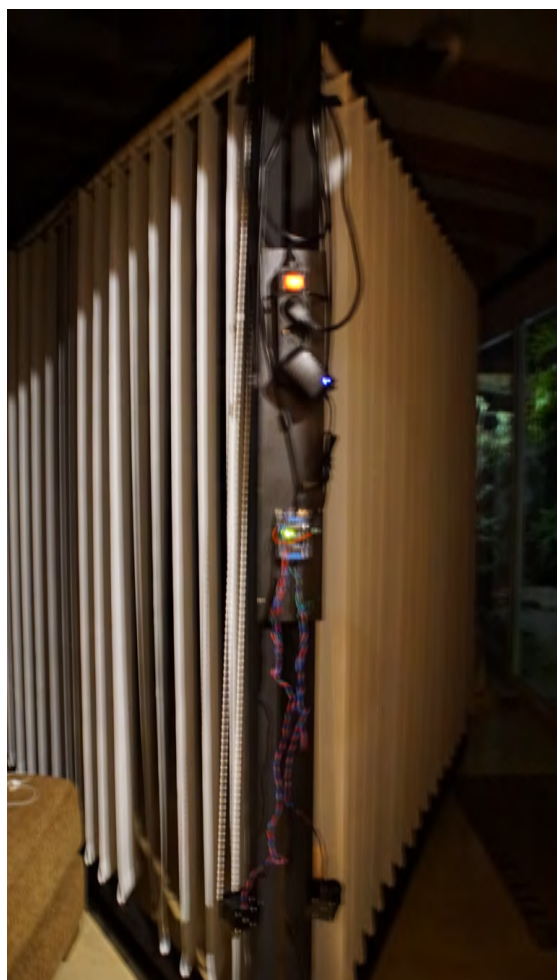
Instalación de la mecanización
