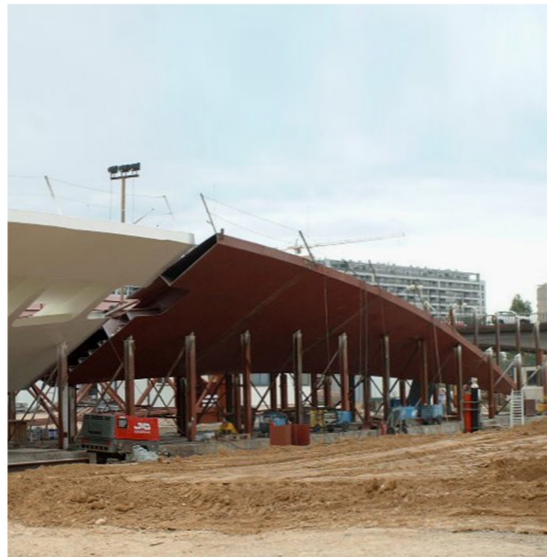
Posa en obra del último elemento de la estructura, la punta. Eliminación apoyos auxiliares. Obra Concluida.
