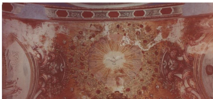
Fig. 27. Estado de la bóveda en julio de 1983.
