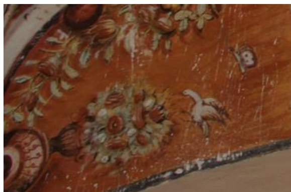
Fig. 29. Detalle del deterioro que ha sufrido la obra en una de sus zonas perimetrales.
