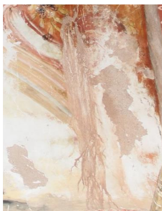
Fig. 25. Detalle escorrentía superficial en la zona derecha inferior de la bóveda.
