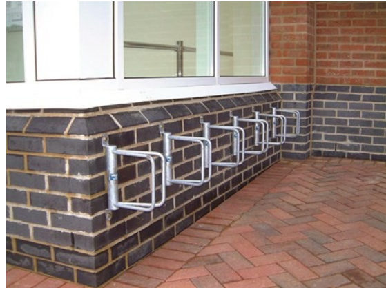
Imagen 58. Conjunto de estacionamientos instalados
