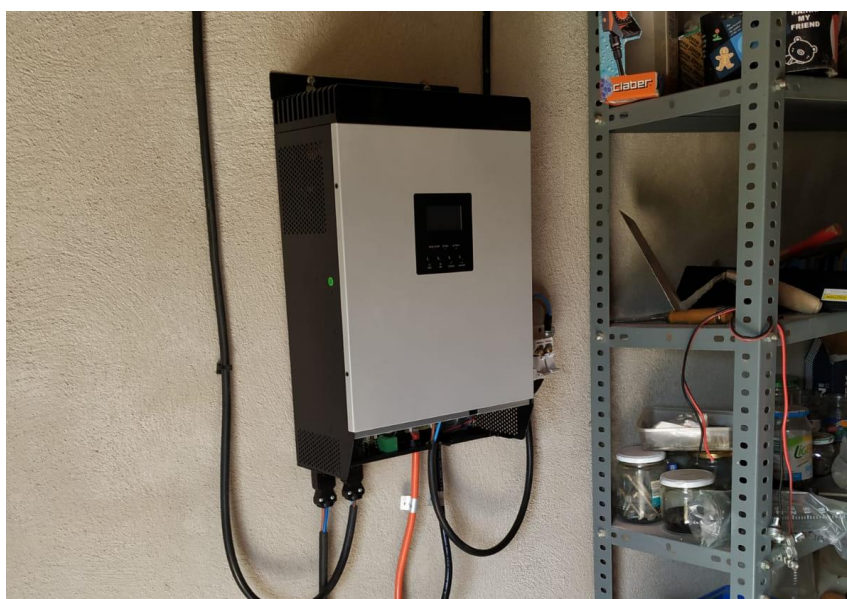
Ilustración 21: Inversor de corriente. (Fuente propia, 2019)
