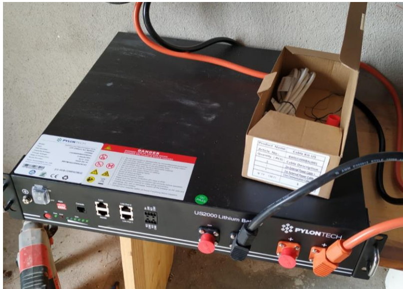
Ilustración 22: Batería de ión de litio. (Fuente propia, 2019)
