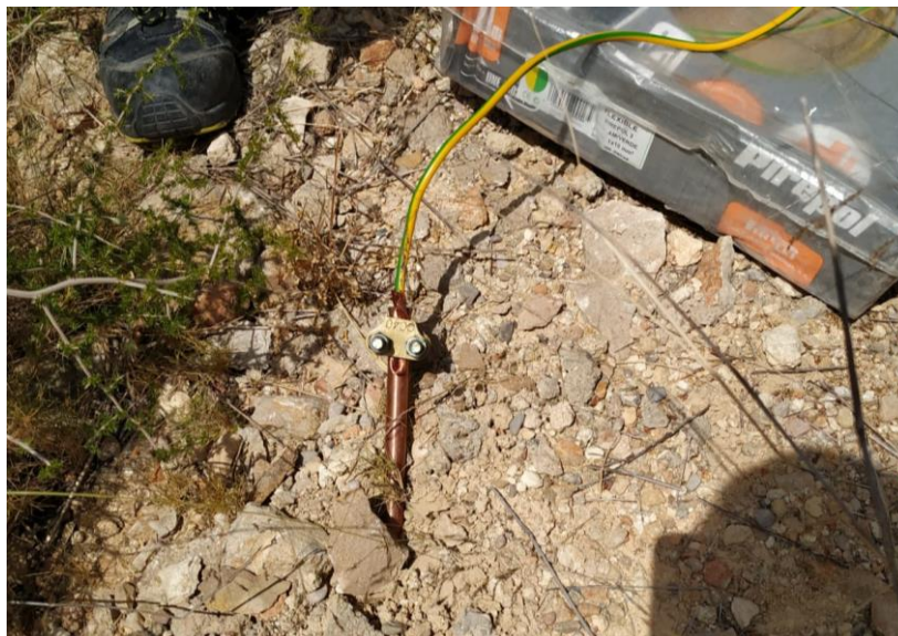
Ilustración 23: Toma a tierra de cobre. (Fuente propia, 2019)
