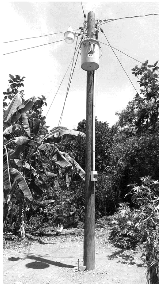
Imagen VI.4.3 . Vue du reseau, Magazen, Haïti, 2017.
