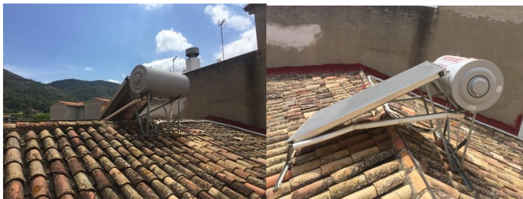
Figura 11. Imatges del captador solar per a l'abastiment d'ACS. Font: elaboració pròpia
