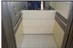
imatge 2: Cabina ascensor
