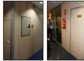
Imatge 5: Mecanismes d'alarma i extintors
