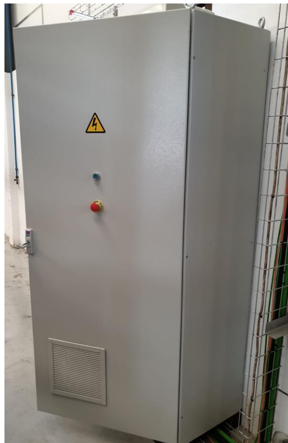
Ilustración 14 Exterior cuadros eléctricos "fuente: elaboración propia"
