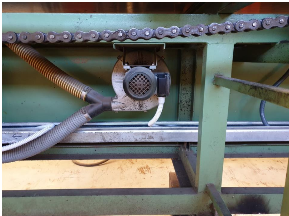
Ilustración 10 Ventilador para calefacción "fuente: elaboración propia"
