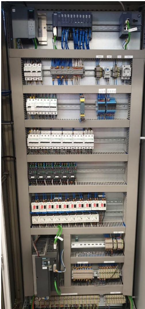
Ilustración 15 Interior Cuadro principal
