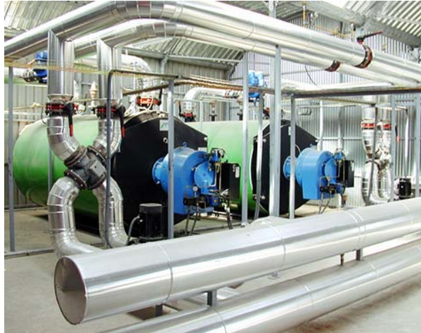
Ilustración 17.- Calderas calefacción por agua
