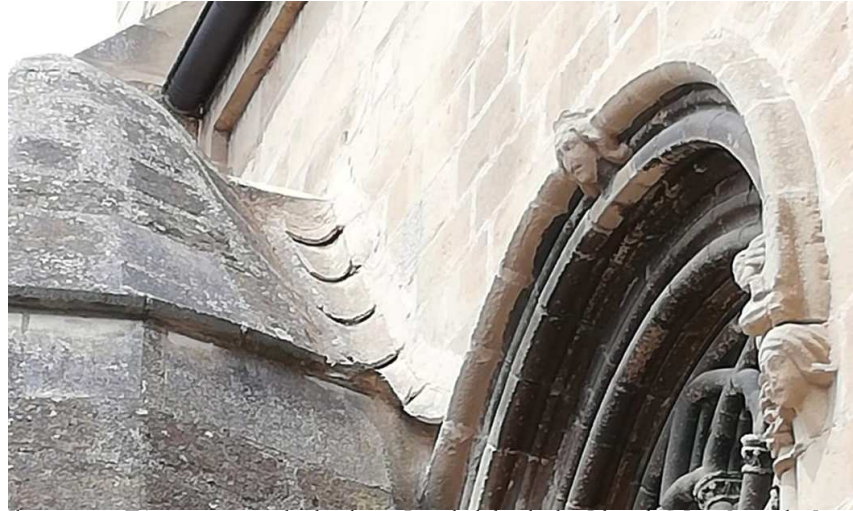
Ilustración 13. Tejas en punto singular de cubierta. Portada de los abuelos. Iglesia de S. Juan. Laguardia. La Rioja. Fuente: Propia.
