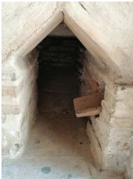
Ilustración 8. Desagüe en L'Alquería de Barrinto. Centro de recepción del parque de Marxalenes. Valencia. Fuente: Propia.
