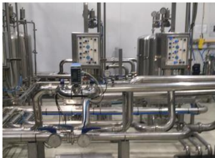
Figura 4. Detalle de la sala de filtros.
