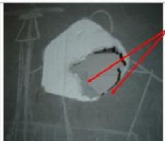
Foto 08B: Detalle de placa dañada, contiene amianto
