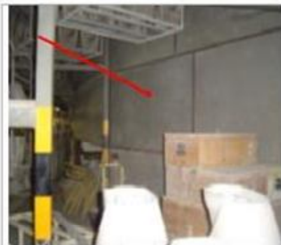
Foto 08A: Placas de fibrocemento, contienen amianto.
