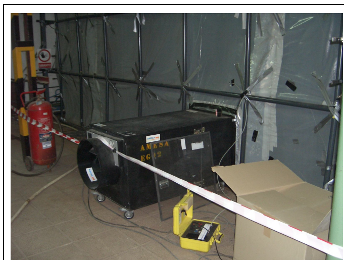
Figura 51. Depresor y monitor de control
