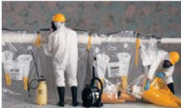
Figura 54. Amianto friable en tuberías
