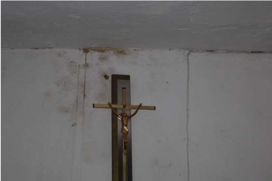
Figura 45. Mancha de humedad. Fuente propia.
