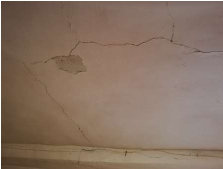
Figura 48. Fisuras en parte inferior de forjado. Fuente propia.
