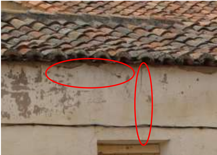
Figura 42. Fisuras en fachada Norte. Fuente propia.
