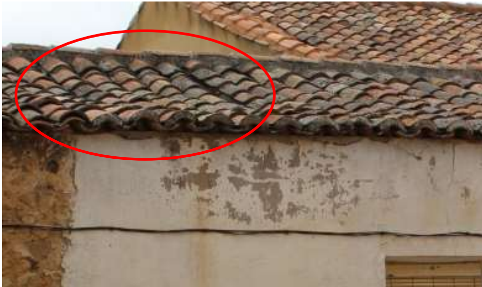
Figura 44. Hundimiento parcial de la cubierta. Fuente propia.
