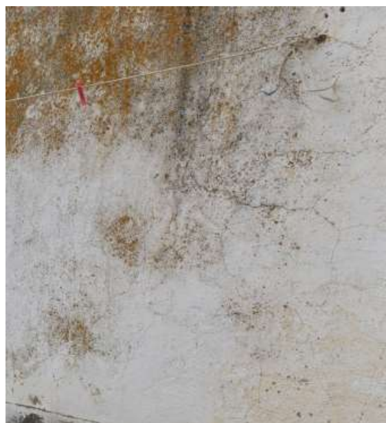
Figura 43. Fisuras fachada Este. Fuente propia.
