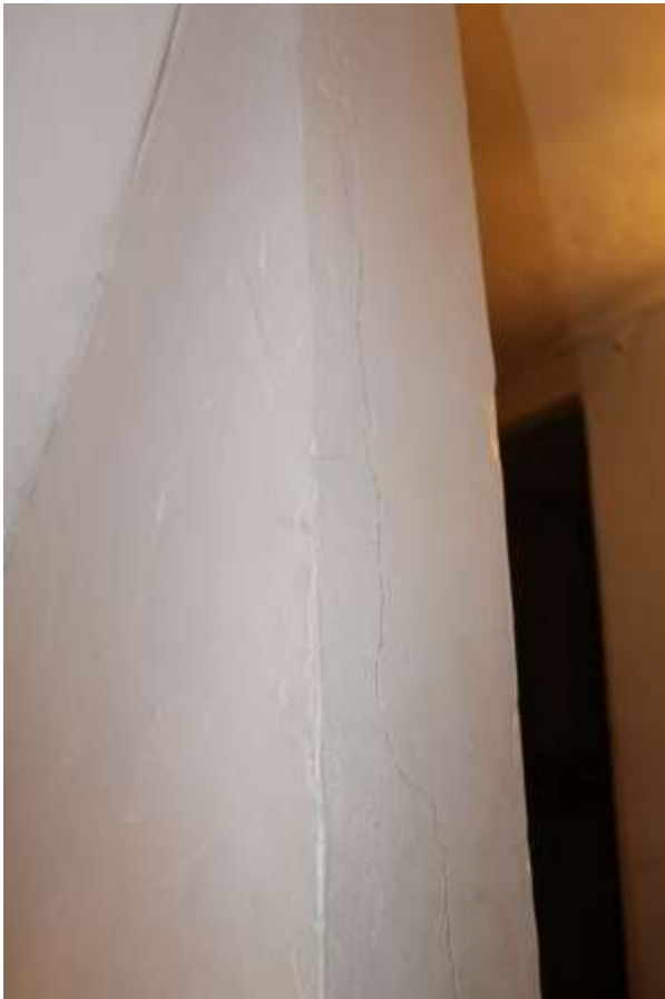
Figura 46. Grieta vertical en partición. Fuente propia
