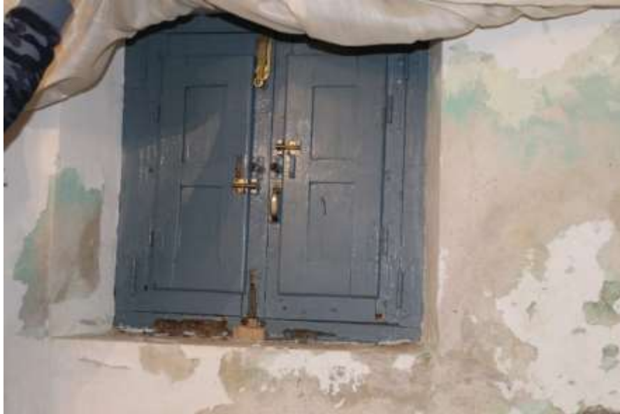
Figura 33. Ventana del comedor con la madera podrida y humedad en la pared. Fuente propia.
