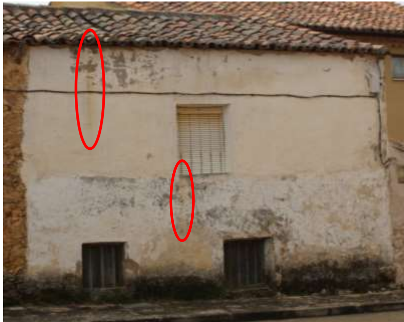
Figura 40. Manchas verticales en fachada Norte. Fuente propia.
