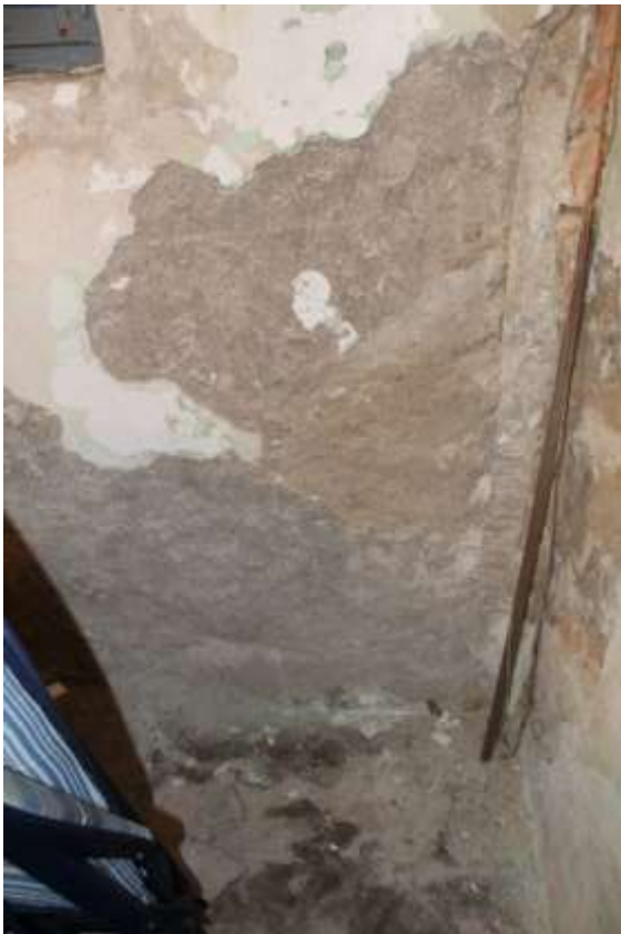
Figura 34. Cara interior del muro en el comedor afectado por la humedad. Fuente propia.
