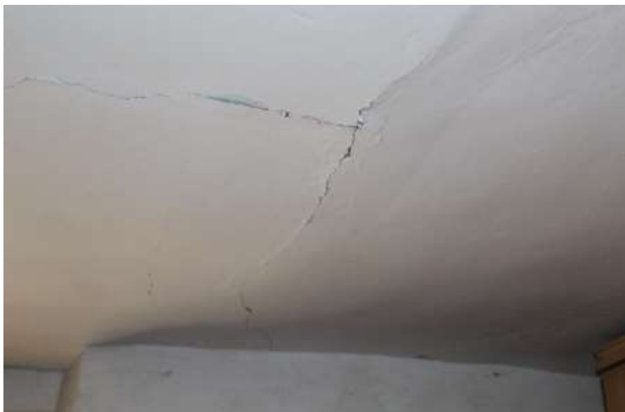
Figura 49. Fisuras en parte inferior de forjado 2. Fuente propia
