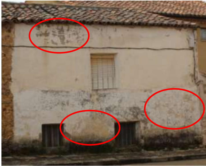
Figura 38. Desconchones de la pintura en la fachada. Fuente propia.
