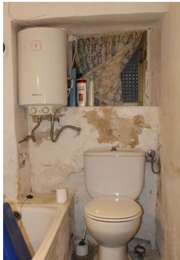
Figura 35. Cara interior del muro en el cuarto de baño afectado por la humedad del muro. Fuente propia.
