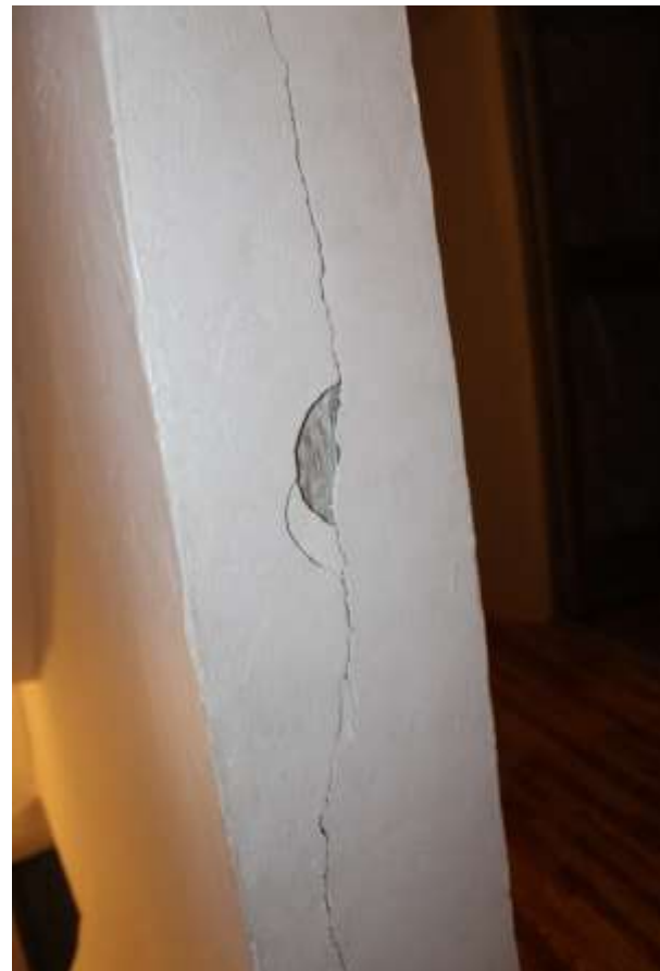
Figura 47. Desprendimiento del revestimiento y grieta en partición. Fuente propia.
