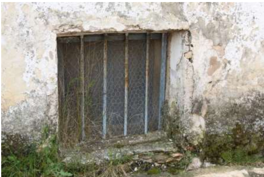
Figura 37. Organismos vegetales en la parte inferior de la fachada Norte. Fuente propia.
