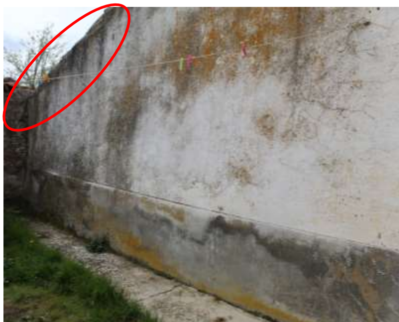
Figura 41. Manchas verticales en fachada Este. Fuente propia.
