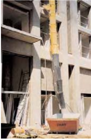
Figura 7: Ducto de Conducción de Escombros
