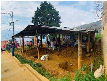
2.3.1.13. Foto Huecos de zapatas, primeros convites para la construcción de la sede comunitaria. El Faro, 2019.
