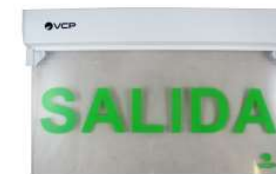
Luz de emergencia con indicador de salida de edificio
