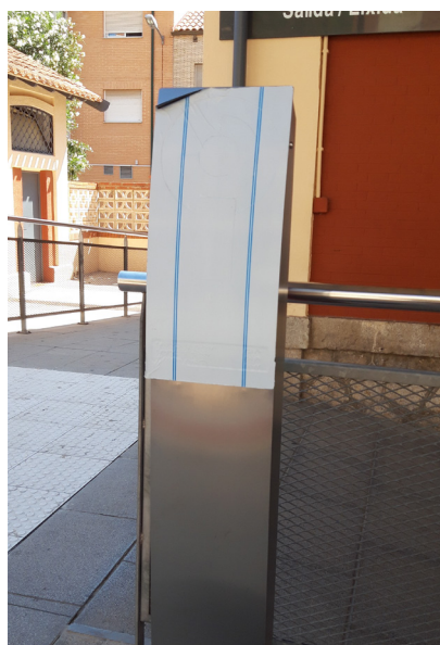
Figura 65: Intèrfon d'emergència fora de funcionament. Imatge pròpia.
