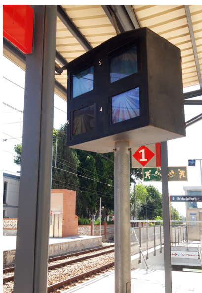
Figura 64: Pantalles amb imatges de les càmeres a l'andana. Imatge pròpia.
