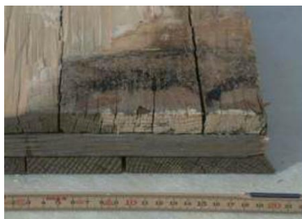
Fig. 51: efecto de la humedad en tablero CLT, Ferk H. 2013
