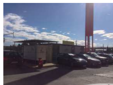
7. Centro de transformación para la estación
