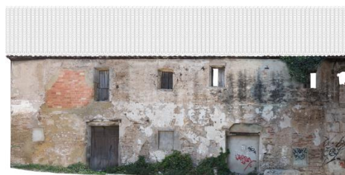
Fig. 85. Montaje en ortofoto del alzado principal del Molí dels Frares. Elaboración propia.
