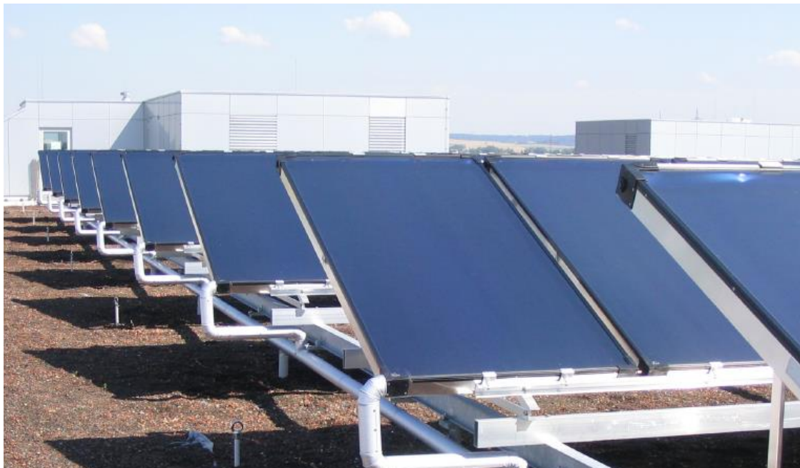
FIG 17. Instalación solar térmica.
