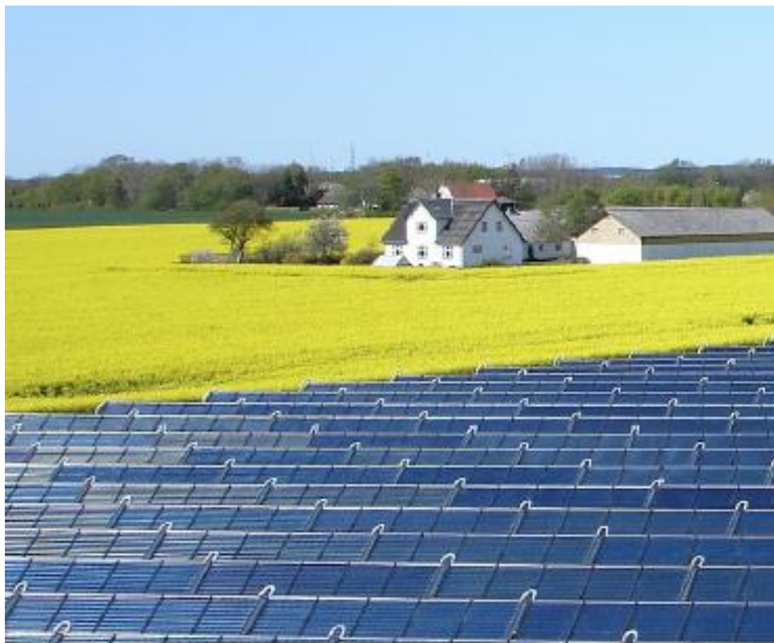
FIG 7. Campo de captadores solares.
