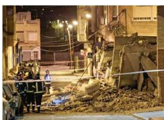
Fig. 22: Edificio que colapsó con el terremoto, Ministerio de Educación, Cultura y Deporte
