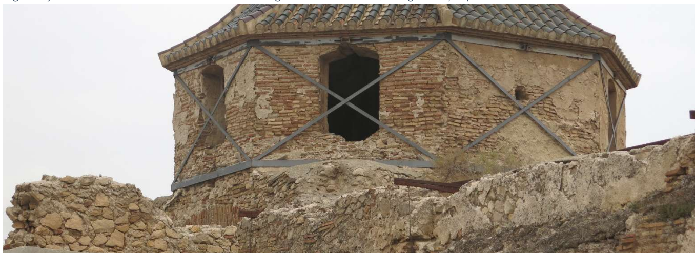
Fig. 63 y 64: Detalles del ladrillo cerámico de la Iglesia de San Juan, fotografías propias
