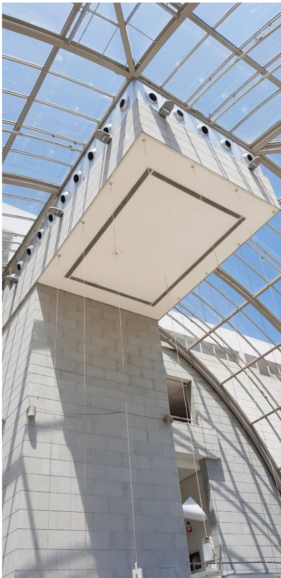
Fig. 31 Sistema de aire acondicionado en el interior del Palau de la Música (Elaboración propia)
