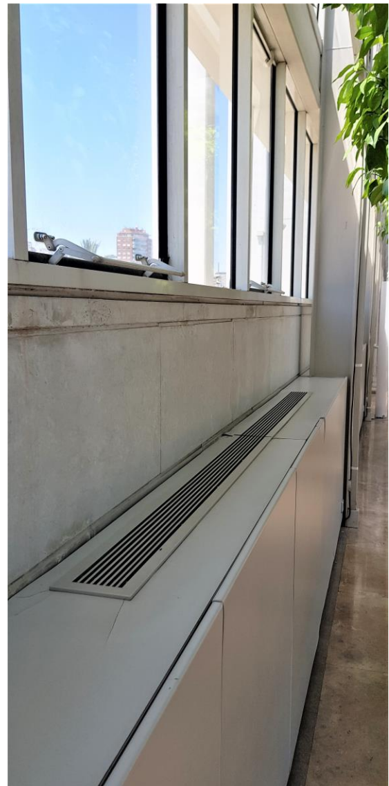
Fig. 32 Sistema de aire acondicionado en el interior del Palau de la Música (Elaboración propia)
