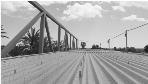
Fig. 130. Cubierta ligera de chapa grecada. Fotógrafo: Gemma Aparicio. [Fuente: Estructuras Singulares I UPV]
