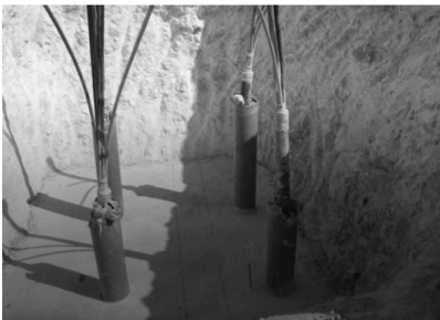
Fig. 72. Tirantes de cimentación. Fotógrafo: Estudio FSA [Fuente: Estructuras Singulares I UPV]
