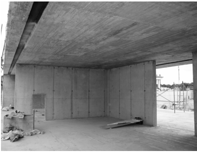
Fig. 35. Casa del Atrio en ejecución. . Fotógrafo: Estudio FSA [Fuente: Estructuras Singulares I UPV]
