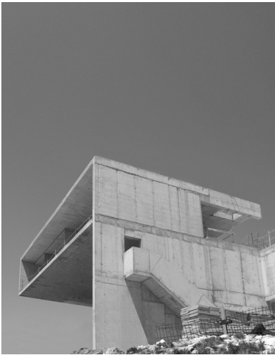
Fig. 67. Fotos de la ejecución. Muro extremo piscina Fotógrafo: Estudio FSA [Fuente: Estructuras Singulares I UPV]
