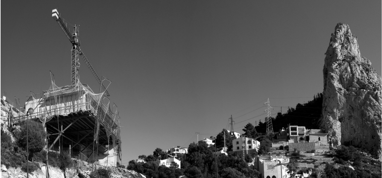
Fig. 65. Casa del Acantilado en ejecución. Fotógrafo: Estudio FSA [Fuente: Estructuras Singulares I UPV]
