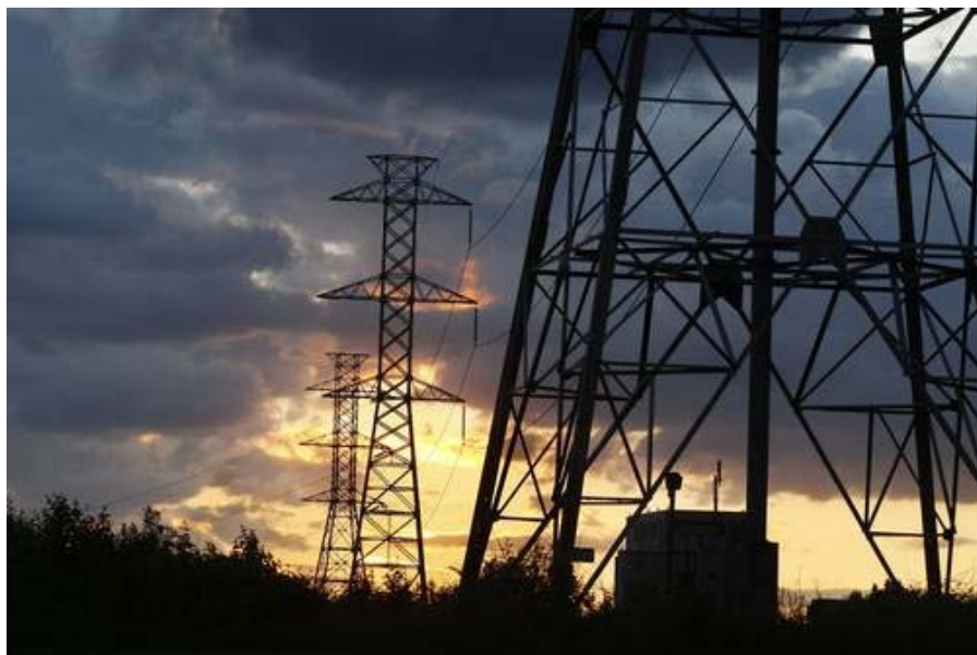
Cuadro 5. Torres eléctricas de alta tensión.
