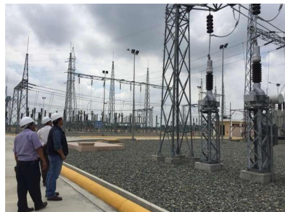
Imagen 12 Vista sub-estación eléctrica en el Ecuador Fuente: https://lahora.com.ec/losrios/noticia/1102193077/mañana-se-suspende-la-energía-eléctrica-por-cuatro-horas
