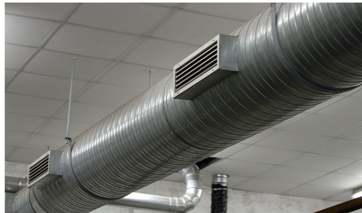
Conductos de climatización
