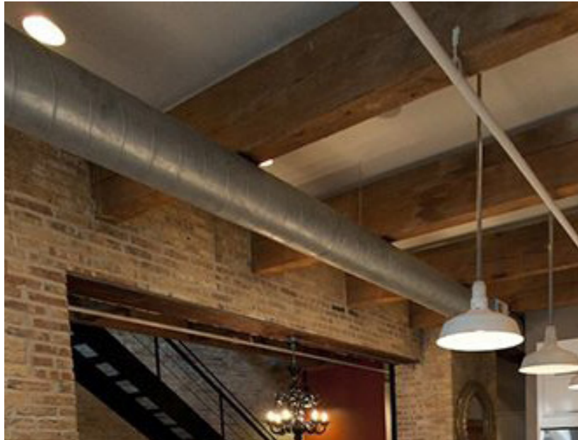
Conductos de climatización vistos con estructura de madera
