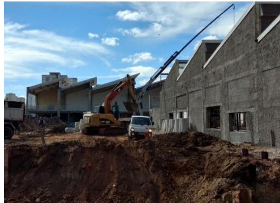
Ilustración 63 - Exterior de la Nave B durante la obra (Fuente: Andrade Morettin Arquitectos)
