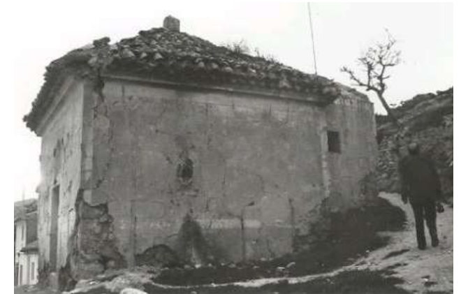
Fig. 4.11: Una de las ermitas del Vía Crucis en estado de ruina.
