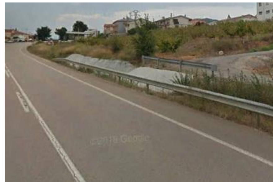
Figura 25: Obra de drenaje longitudinal. (Fuente: Google Earth)
