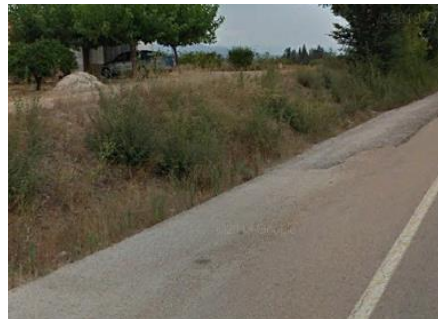
Figura 26: Obra de drenaje longitudinal. (Fuente: Google Earth)
