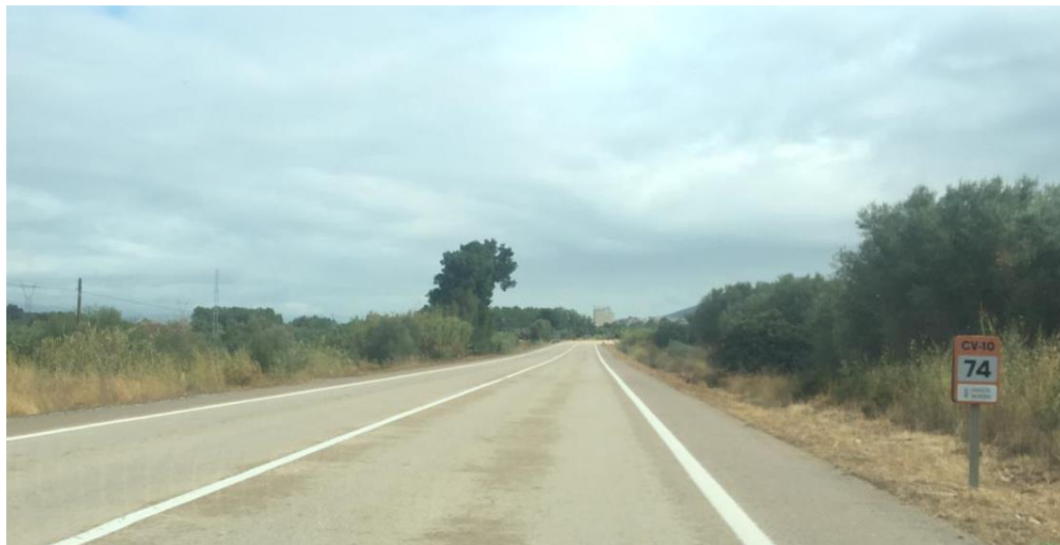
Figura 10: Sección de la carretera en el PK 74+000, previo a entrar en la travesía. (Fuente: Propia)
