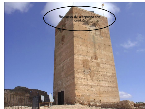
Fig. 106 Recrecido del antepecho de la terraza en hormigón.
