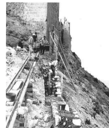
Fig. 87 Restauración de la muralla Sur. Se observa al fondo el tapial original, el cual se eliminó y se construyó por delante de él.
