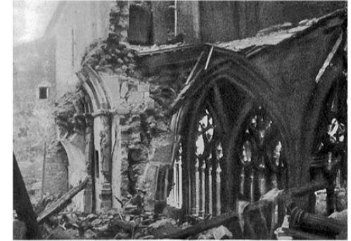
Fig. 11 Ruinas de la voladura en la Cámara Santa de la Catedral de Oviedo
