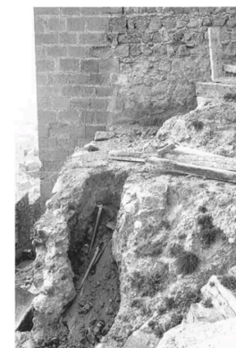
Fig. 89 Excavación para realizar los peldaños de la zona de explanada que conectaba ambos recintos.
