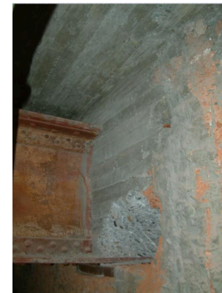
Fig. 34 y 35 Intervención en la Torre de Comares realizada por Leopoldo Torres Balbás empleando el hormigón como refuerzo estructural.
