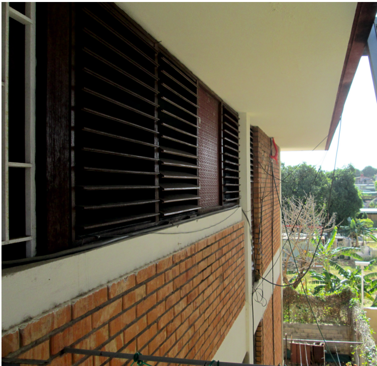
Img. 09. Edificio de Josefina Odoardo, La Habana. (foto tomada en 2013).
