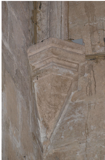
Fig.200. Fotografía de una de las cuatro ménsulas de rincón. [Imagen propia, 2019]
