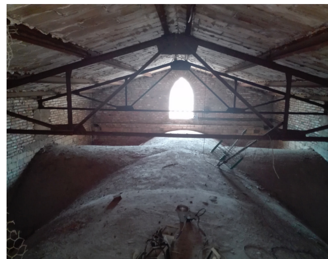
Fig.130. Estado actual del trasdós de las bóvedas del coro. [Imagen propia, 1/2/18]
