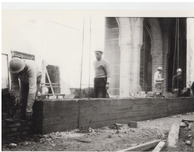
Fig.120. Reconstrucción del muro sur del coro. [Archivo histórico del Monasterio de El Puig, 1968]
