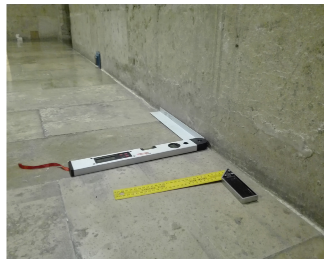
Fig.155. Medición del ángulo del muro en el punto central del coro. [Imagen propia, 2018]
