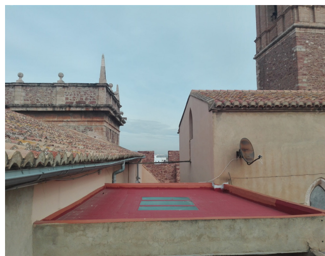
Fig.126. Espacio entre el muro oeste y la fachada del monasterio. Anteriormente el coro ocupaba este espacio y su longitud era mayor. [Imagen propia, 2018]
