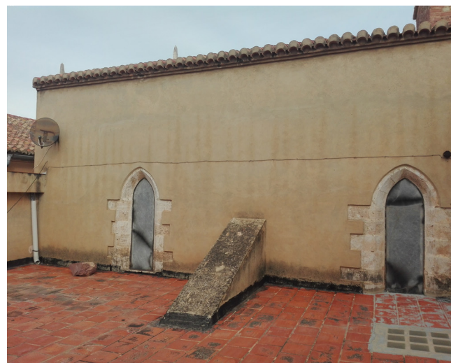
Fig.127. Estado actual del trasdós del muro sur del coro a la altura de la cubierta del Monasterio. [Imagen propia, 2018]
