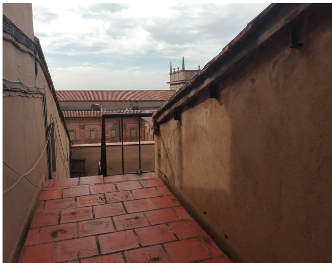
Fig.116. Paso superior en la cubierta del coro. Al fondo la cubierta y el patio del Monasterio. [Imagen propia, 1/2/18]
