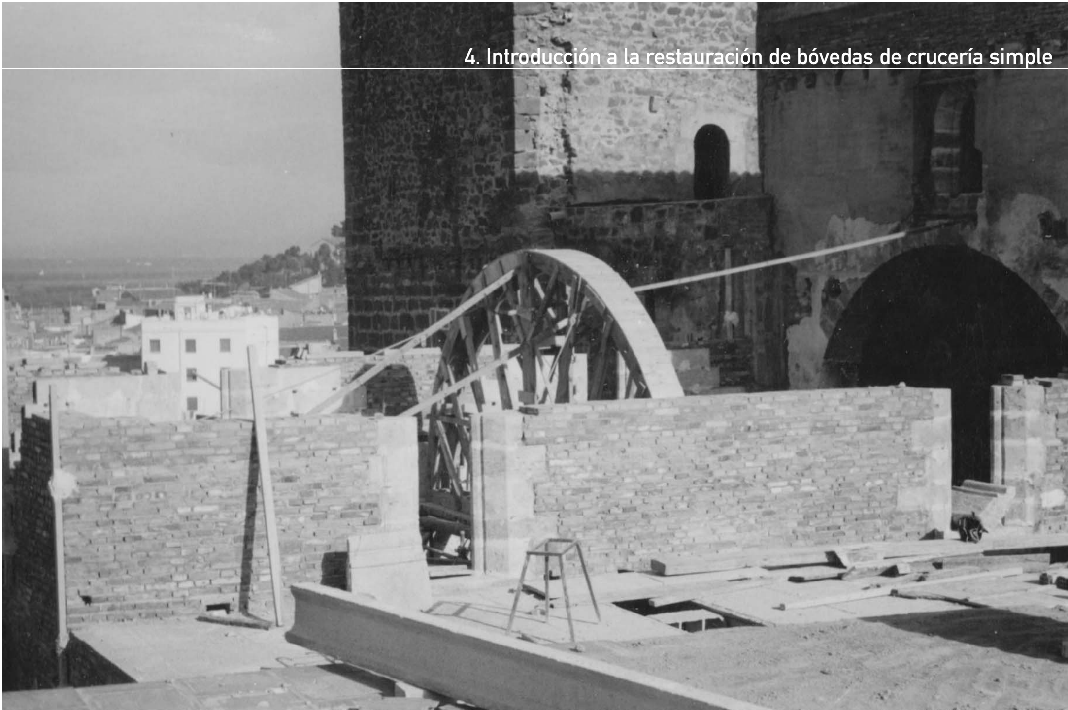
Fig.53. Fotografía de la construcción de las bóvedas de crucería del coro. [Archivo histórico del Monasterio de El Puig, 1968]
