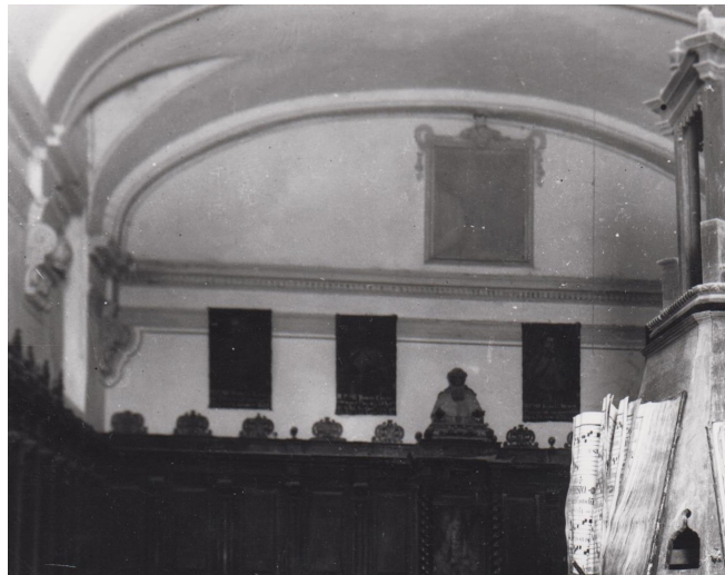
Fig.51. Arcos fajones carpaneles y bóveda de cañón del antiguo coro. [Archivo histórico del Monasterio de El Puig, 1915]
