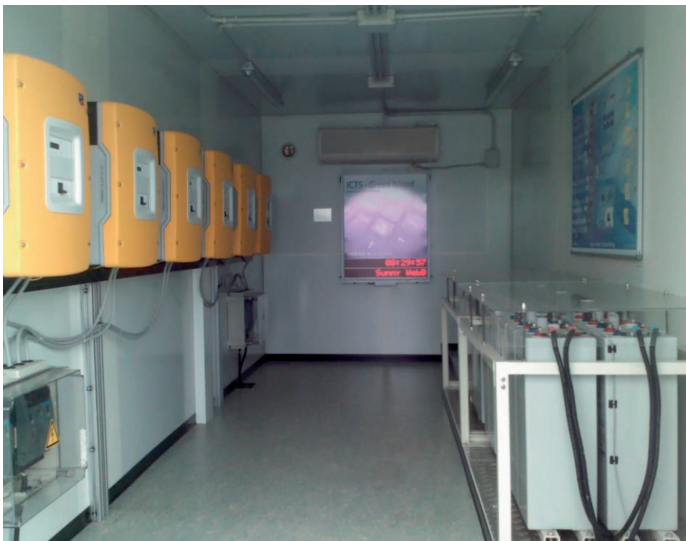
Fig. 6: Vista Interior del contenedor de equipos, fusibles, inversores y banco de baterías instalado
