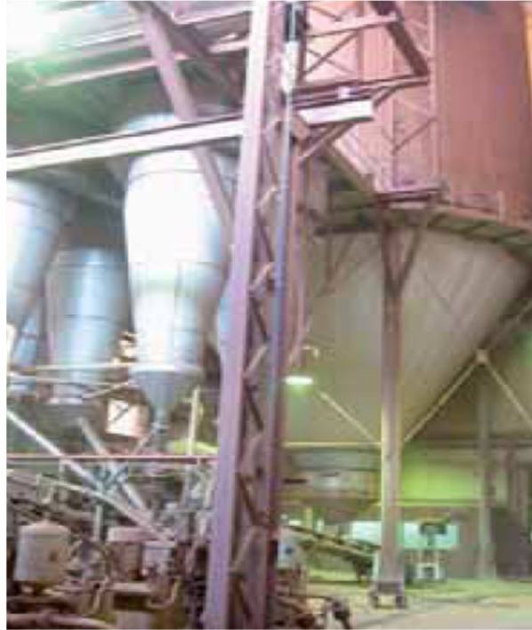
Vista general de un secadero por atomización.
