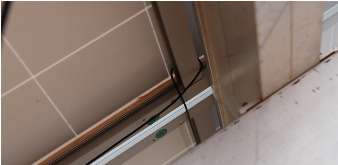
Figura 4. Detall del cable de protecció de les plaques passant per l'estructura d'aquestes.
