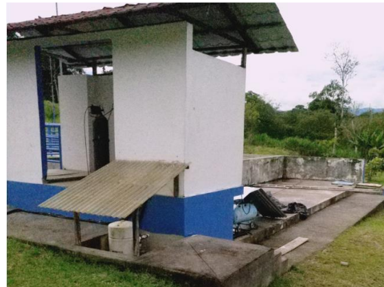
Figura 18. Caseta de cloración.
