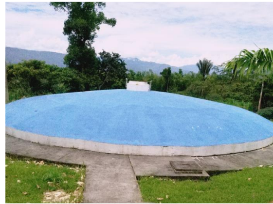
Figura 21. Tanque de almacenamiento de la Planta Nueva.
