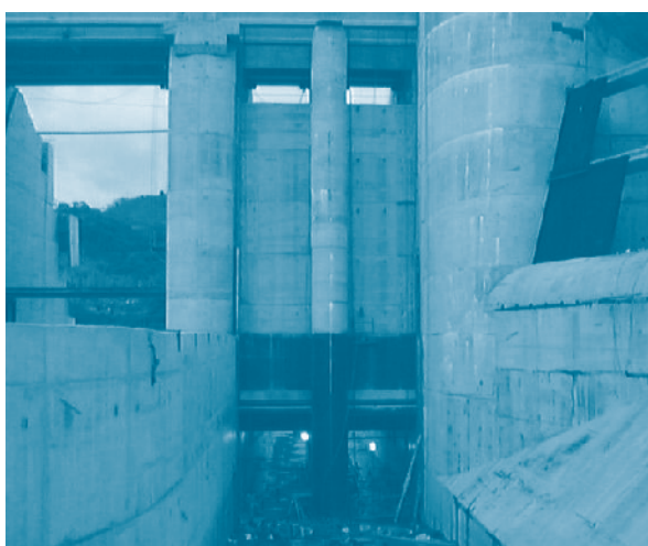
Figura 12. Compuertas de descargas de fondo, a la derecha, la toma de aguas
