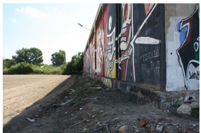
Límite entre lo edificado y la parcela, donde se aprecia el estado de degradación de éste. Fuente: Propia
