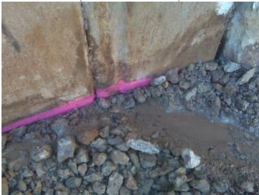
Figura 2.21.- Filtración lateral a través de las planchas de un tablestacado con arrastre de finos (Cortesía de FERRER, S.L.).
