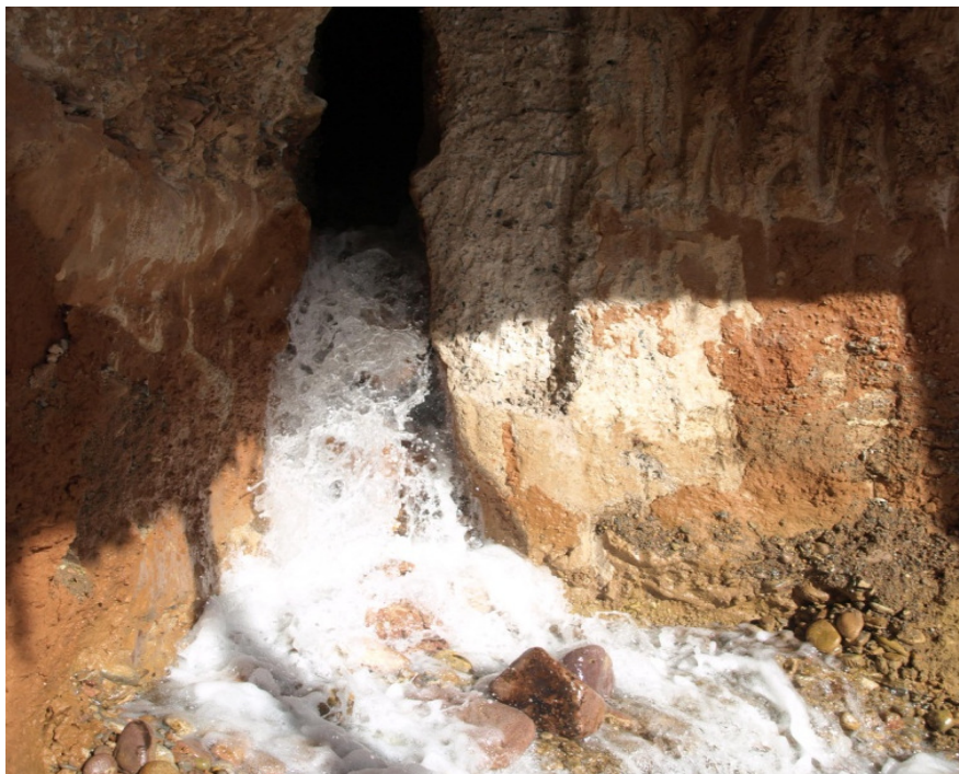
Figura 2.23.- Filtración lateral a través de fallo de junta de muro pantalla (Cortesía de FERRER, S.L.).
