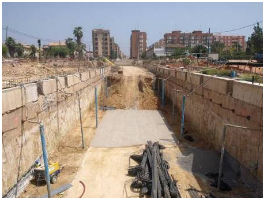
Figura 3.25.- Red de control con pozos de baja capacidad–Línea Férrea (FGV) Alboraya– (Cortesía de FERRER, S.L.).
