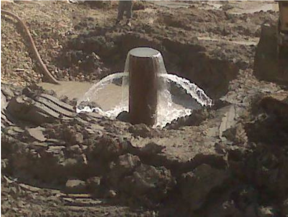
Figura 2.17.- Imagen de surgencia en fondo de excavación. Valencia, 2009 (Cortesía de FERRER, S.L.).
