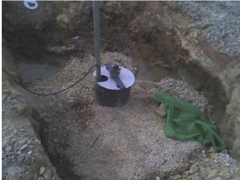
Figura 3.3.- Imagen de sumidero ( sump ) completamente equipado, previo a la ejecución de la excavación (cortesía de FERRER, S.L.).
