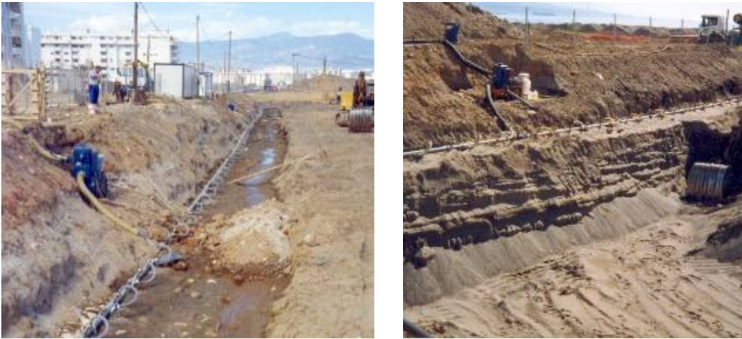
Figura 3.12.- Instalación de sistema wellpoint. Izda. Nivel freático inicial, previo al inicio del bombeo. Dcha. Nivel freático deprimido por la acción del bombeo (Málaga, 2006 - Cortesía de FERRER, S.L.).
