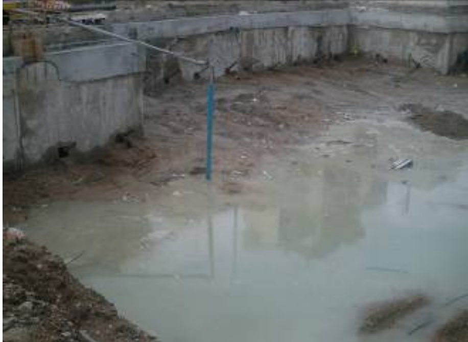
Figura 2.24.- Imagen del estado de la obra por filtraciones laterales a través de los sistemas de anclajes del muro pantalla, con sistema de drenaje interior funcionando. Gandía – Valencia. (Cortesía de FERRER, S.L.).
