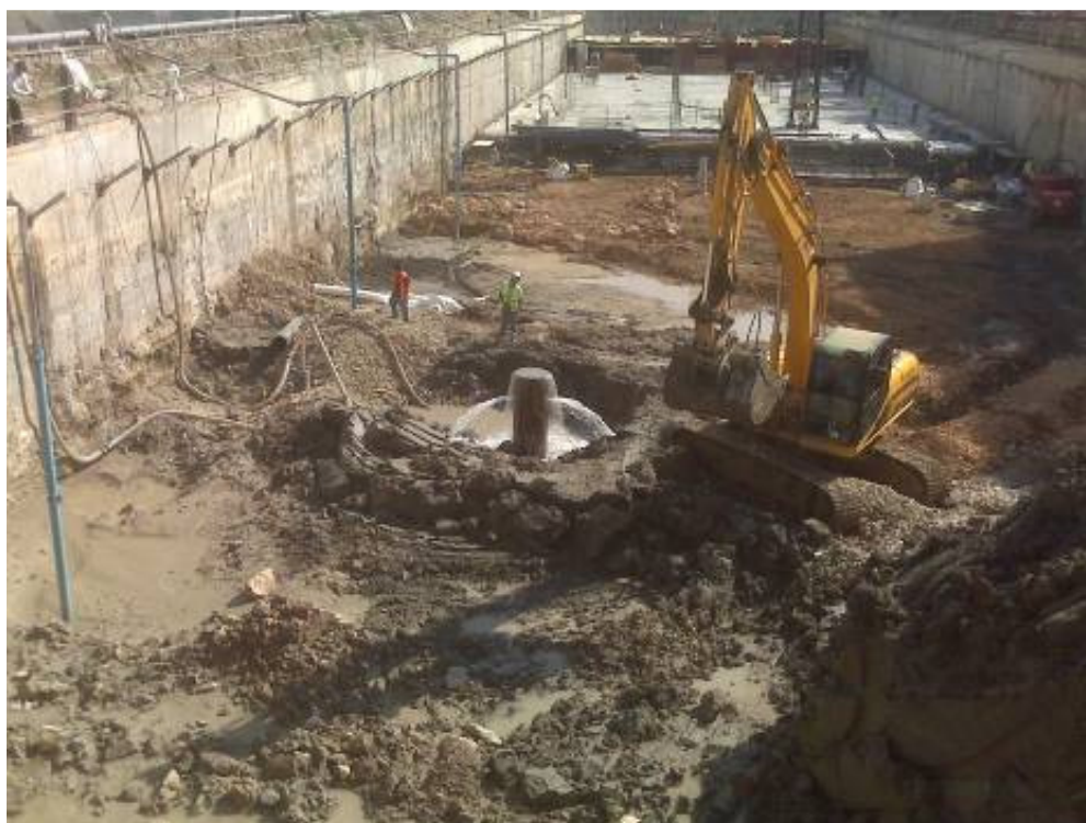
Figura 2.16.- Imagen general de surgencia en fondo de excavación drenada con pozos de baja capacidad. Valencia, 2009 (Cortesía de FERRER, S.L.).
