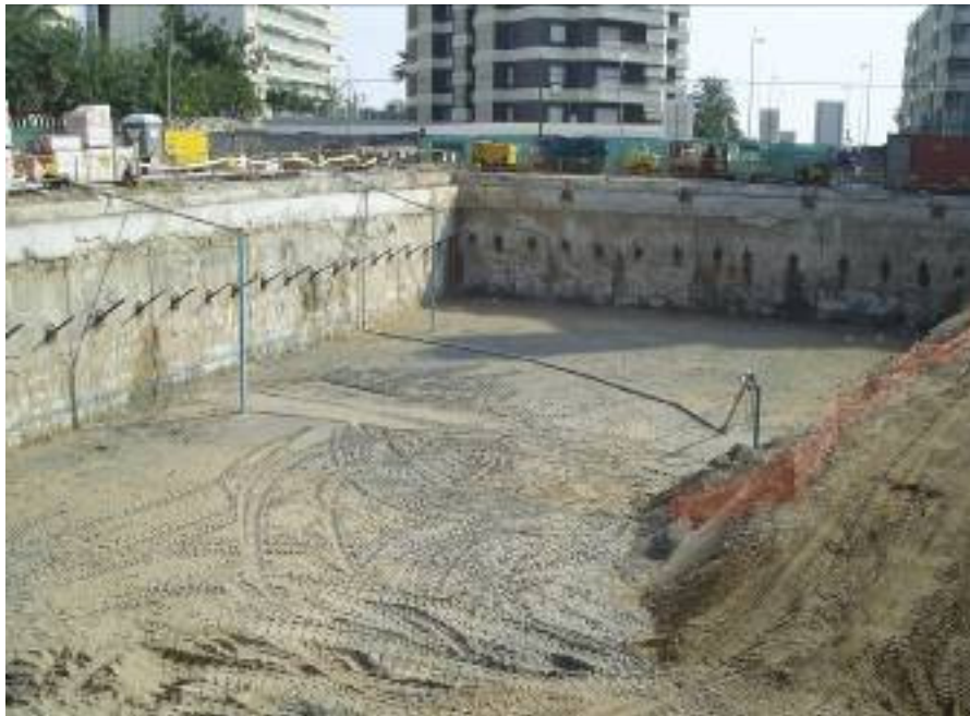
Figura 2.25.- Estado de la obra tras el sellado de las vías laterales, con el mismo sistema de drenaje funcionando que en la imagen anterior. Gandía – Valencia. (Cortesía de FERRER, S.L.).
