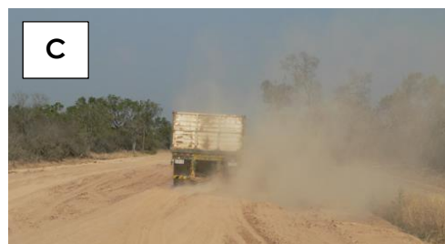
Imagen 1. Ejemplos de carreteras sin firme.
