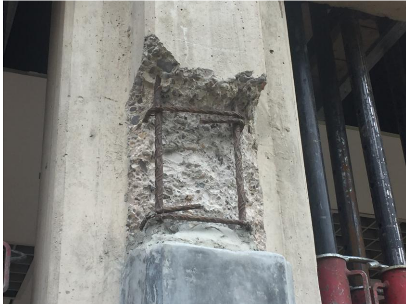
Ilustración V-37 Pilar con barras corrugas al descubierto
