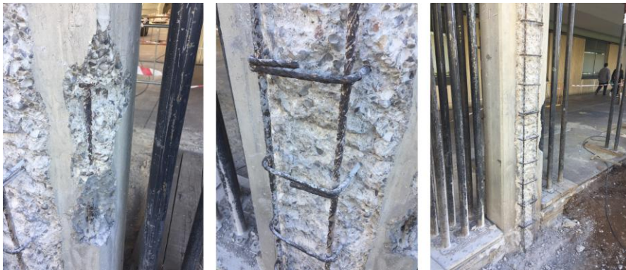
Ilustración III-2 Daños en los pilares de la ETSAV
