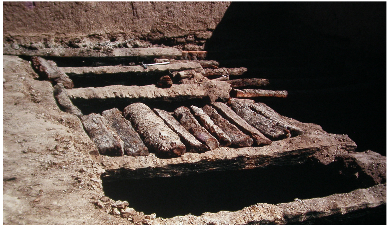
imagen_180 ataque de xilófagos > pérdida de la capacidad portante del forjado
