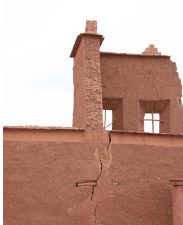
imagen_176 reparación patología grieta muro fachada
