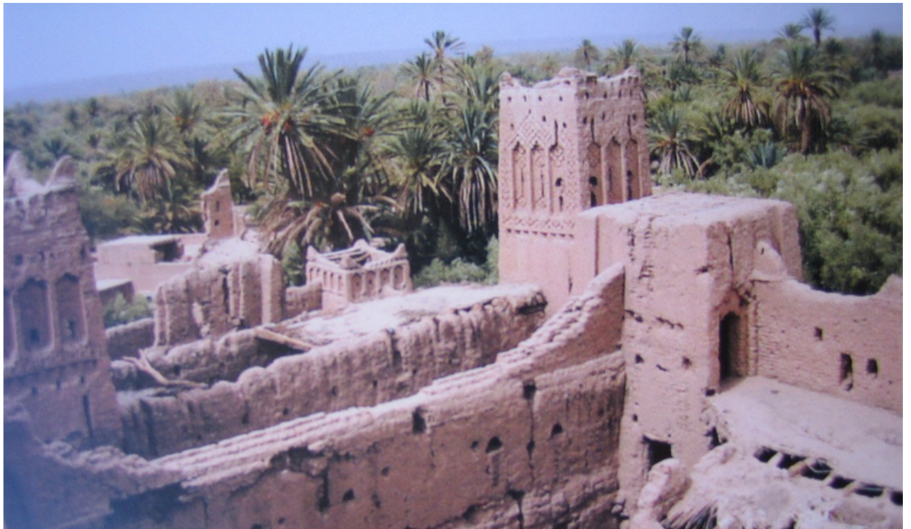
imagen_183 patología química debido a los agentes medioambientales
