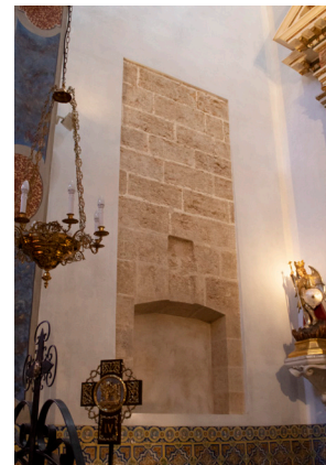
Fig 30. Detalle de obra faltante
