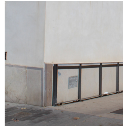
Fig 15. Encuentro entre zócalo existente y nuevo zócalo
