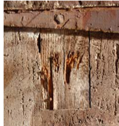
Fig 72. Detalle del taco de madera empotrado en la bóveda sobre el cual se calvaría el panel de madera
