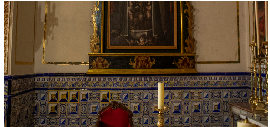
Fig 14. Humedades existentes de fachada norte
