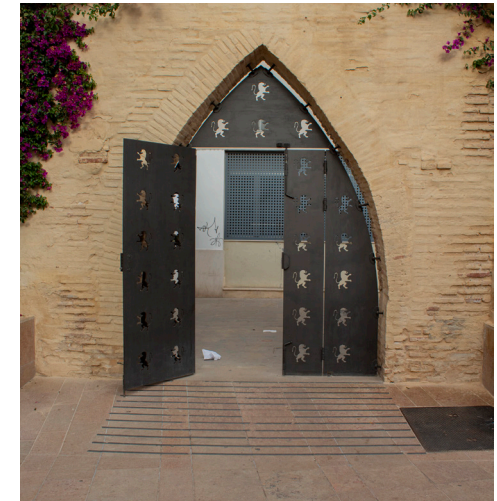
Fig 66. Estado actual de la puerta de Plegateles
