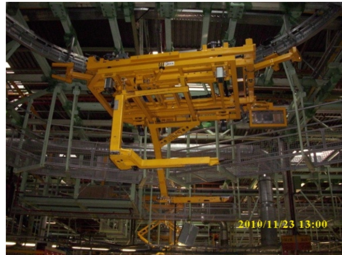
Fotografía de la electro-vía colgada
