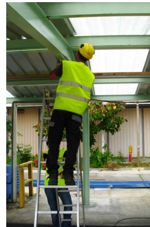
Uso correcto de la escalera de mano, con el apoyo de una persona a nivel del suelo sujetándola.
