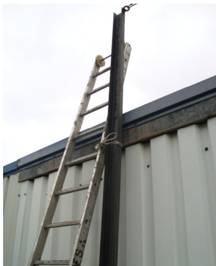
Escalera utilizada como medio de acceso a la cubierta. Atada en su parte superior y sobrepasando 1 metro el punto superior de apoyo.
