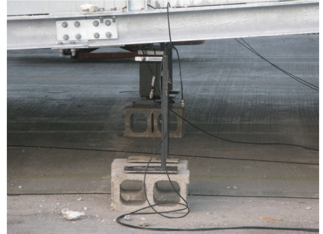
Sensor encargado de medir los asentamientos y las flechas que sufre la estructura al realizar la prueba de carga.
