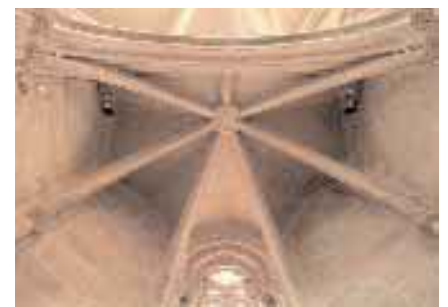
Fig. 1: Vista cenital de la capilla de la iglesia de Sant Mateu. Fuente: Propia
